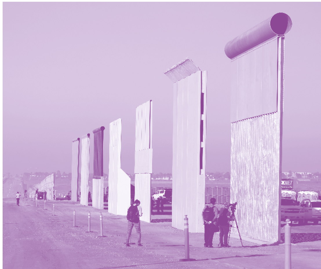
Sitio de construcción del muro fronterizo cerca del puerto de entrada de Otay Mesa. En la oportunidad se dieron a conocer ocho prototipos diferentes en la frontera entre Estados Unidos y México. 26 de octubre de 2017. / Border wall construction site near the Otay Mesa port of entry as eight different prototypes of the border wall were unveiled at the u.s. border with Mexico. October 26 2017. © u.s. Customs and Border Protection, Yesica Uvina
